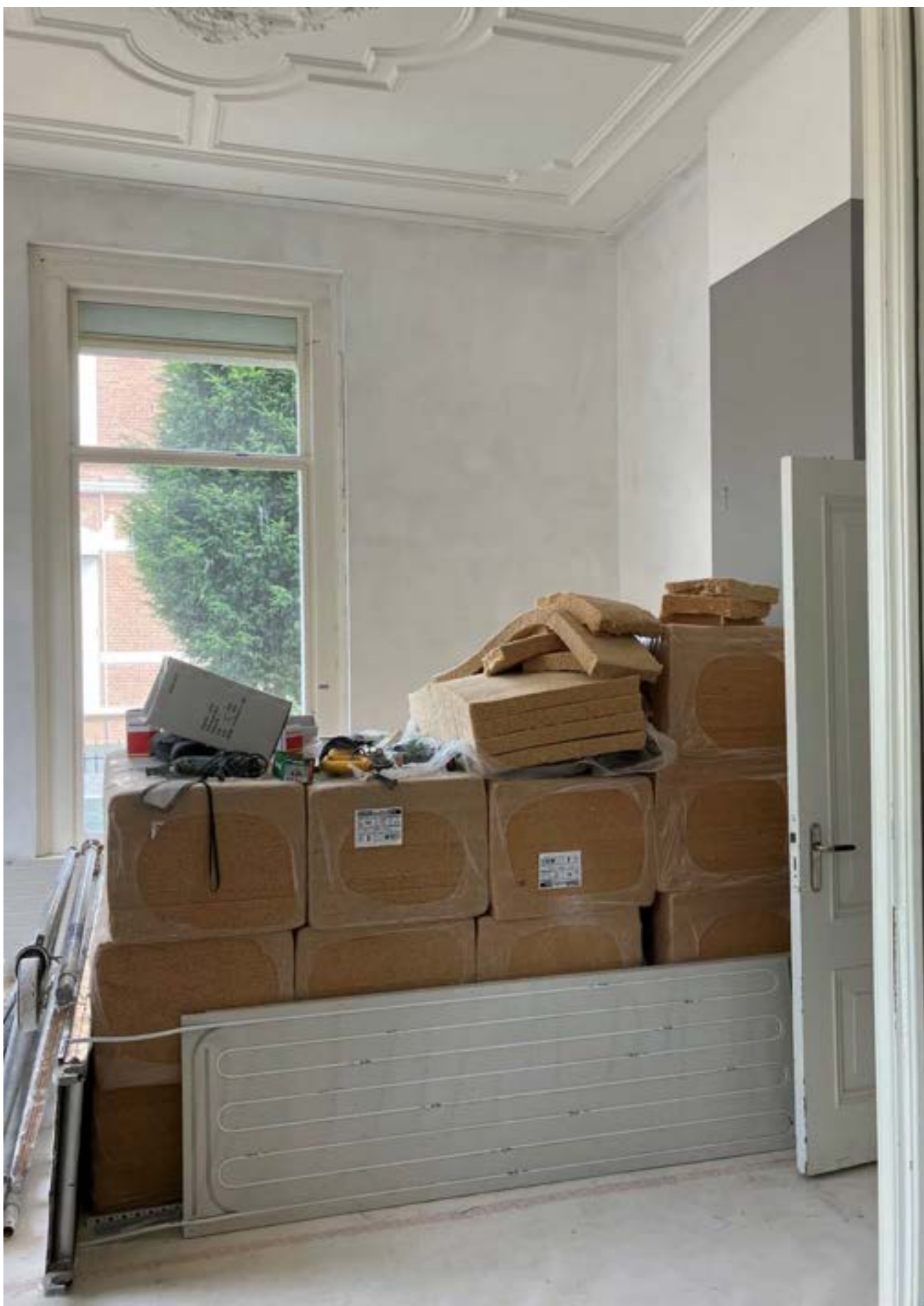
▲ Afbeelding XXV Houtvezelisolatie en gipsplaten met wandverwarming in een monumentaal interieur. Wat hier niet goed is gegaan, is dat de geïsoleerde voorzetwand bij het raam niet is doorgezet tot aan het kozijn; hier is dus eigenlijk het detail rechtsonder op detailblad 4.01 gemaakt.
