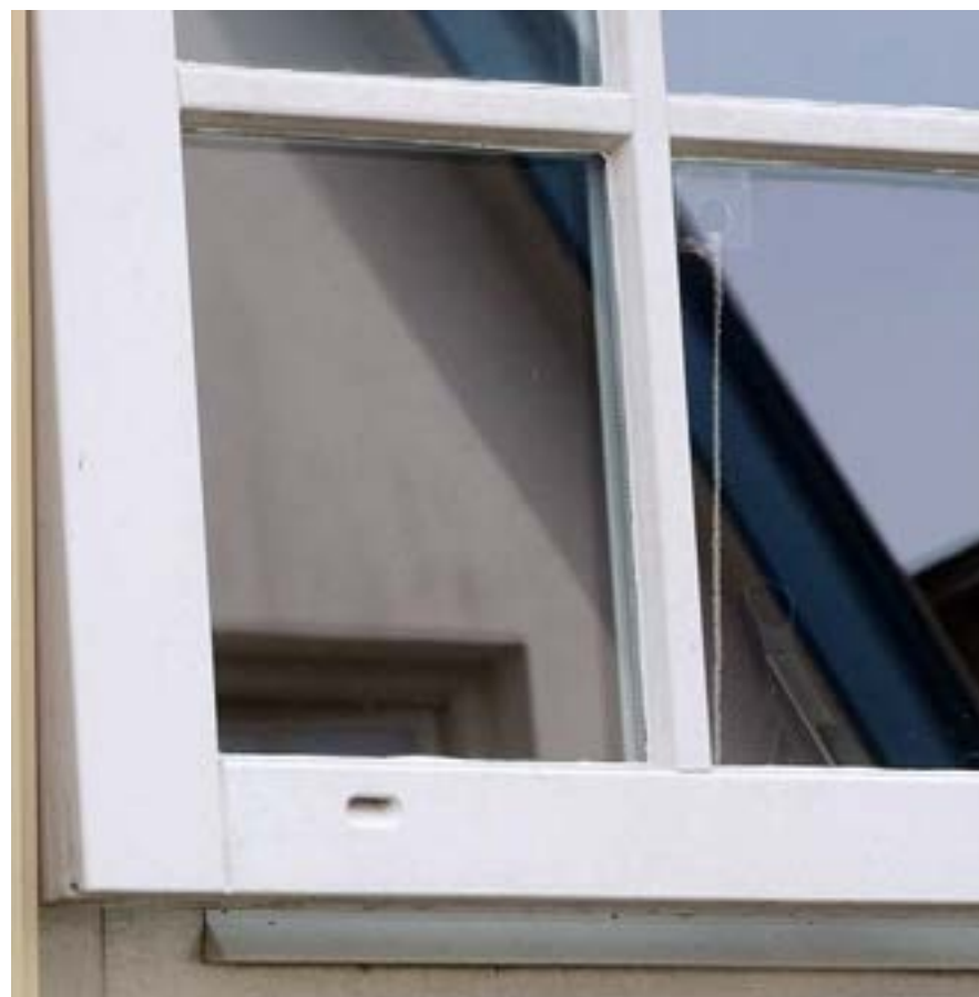
▲ Afbeelding XXXI Nieuw naar buiten kleppend bovenlicht ter plaatse van een voormalig schuifraamvenster, met een binnenbeglazing, ontwaterings-/beluchtigsgat voor het isolatieglas links onder, plakroeden en v-groeven.
